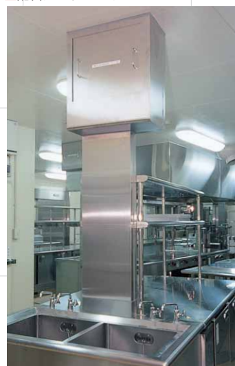
■配管ダクトチェイス
