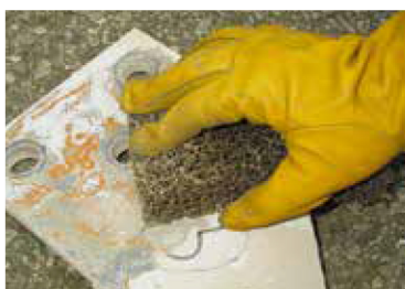
古い塗膜剥離
