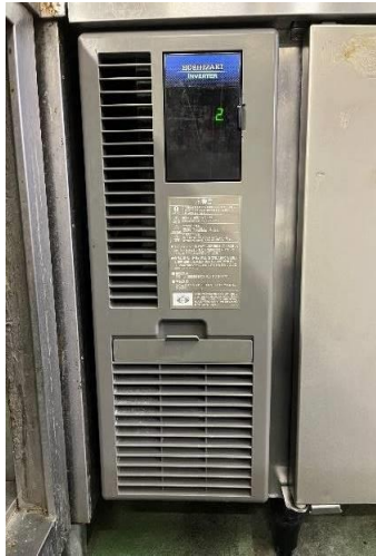
冷蔵庫制御部 (外観)
