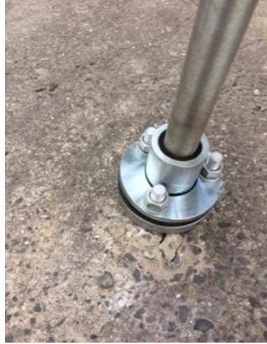
設置不可コンクリート②
