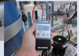
● 水処理装置 (配管圧力確認)
